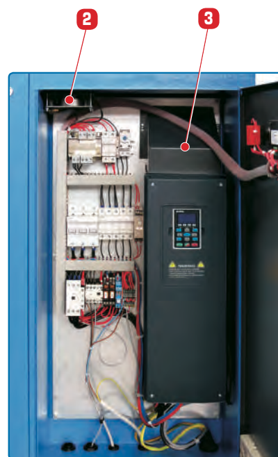
Quadro elettrico e inverter.
