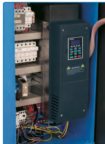
Quadro elettrico e inverter.
